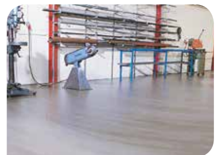
I detta fall lackeras ytan. Golvet togs i bruk redan nästa dag.
